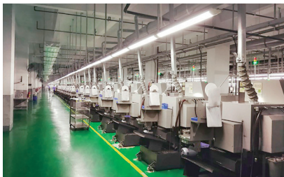
中央空调车间 Central air conditioning plant
