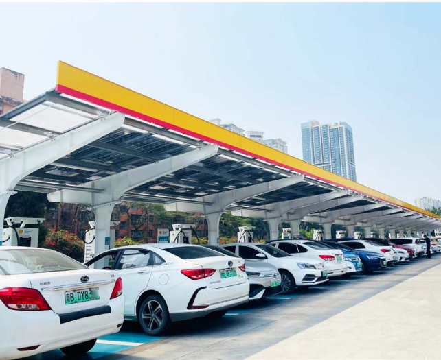
壳牌比亚迪充电站项目
