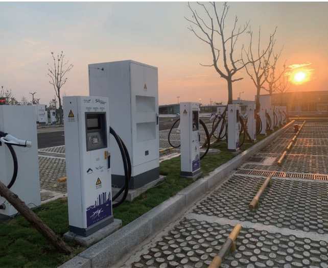
成都天府机场充电站项目
